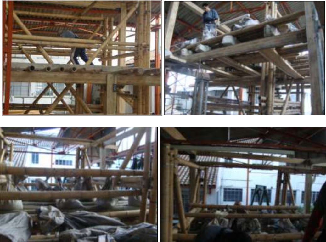
Figura 36: Sacos de arena v vigas de concreto usados en prueba de carga
